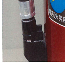
× 消火薬剤の漏れ
